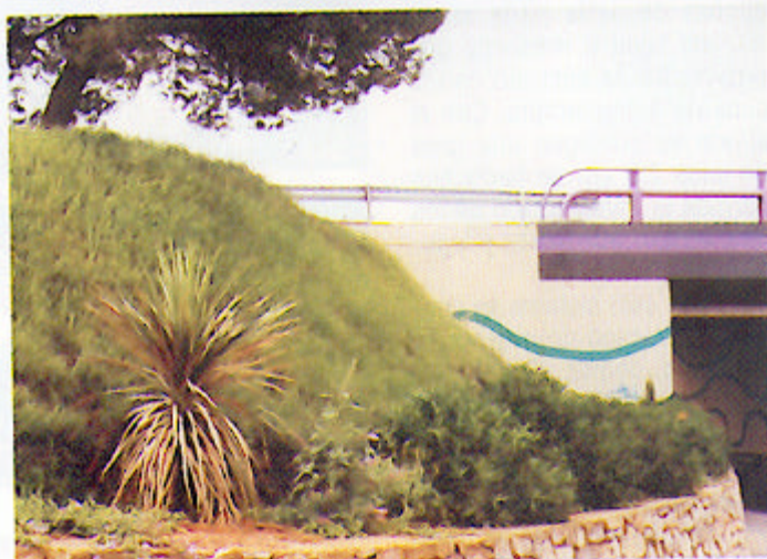
Proyección de sustrato sobre la malla volumétrica Trinter; abajo: resultados del tratamiento.
